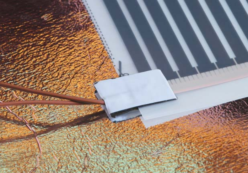
Рис. 19. Вид заизолированного контактного зажима с подключенными проводами
