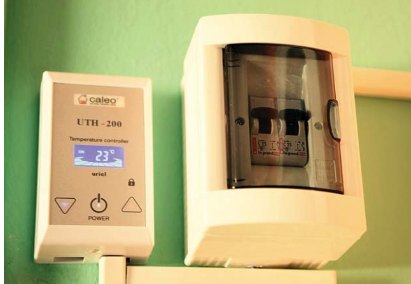
Рис. 26. Терморегулятор, подключенный к сети через отдельный автомат
